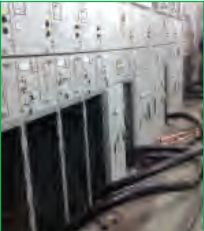
变电站内,10kV入柜电缆
