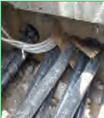
变电站外,10kV电缆外线进线部位
