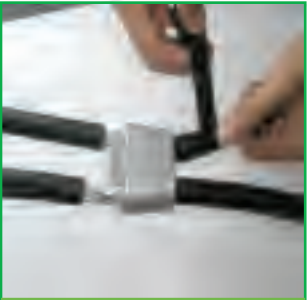
10kV架空绝缘导线接头处未作防水绝缘处理的初始形态
