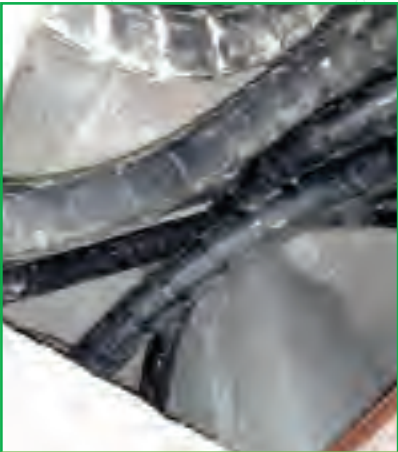
变电站内,10kV电缆转弯部位
