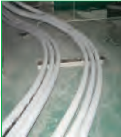
变电站内,10kV并排电缆密集部位
