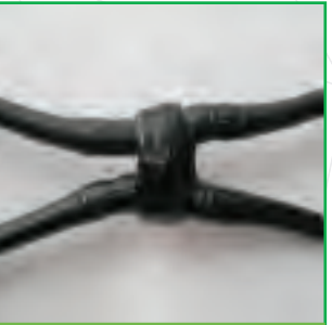
10kV架空绝缘导线接头处已做防水抗紫外线处理的效果
